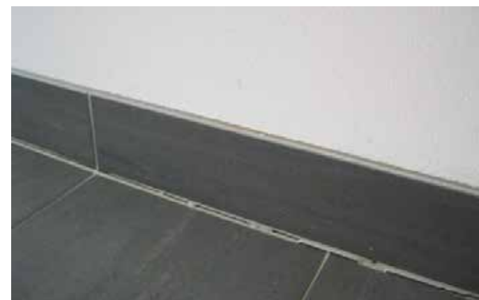
Obr. 23 – Potrhaná dilatační spára bez použití separačního provazce
